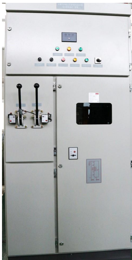
Рис. 6.7 - Шкаф автоматического байпаса
